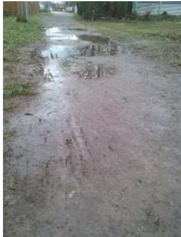
Zustand bei Regen
